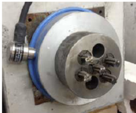
Figur 11. Lastcell monterad mellan ankarhuvud och ankarplatta i ett VSL-system. Från [8].
