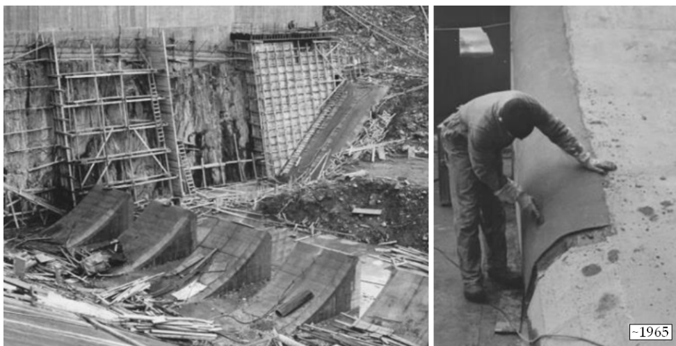
Figur 38. Samtliga strålllyftare förstärktes med epoxibeläggning på hörn och kanter i samband med Moforsens kraftverksbygge 1964–1967. Foto Uniper via C-O Nilsson.
