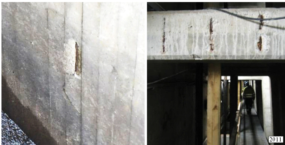
Figur 44. Två exempel på armeringskorrosion i betongkonstruktioner inom vattenkraften till följd av för tunt täckande betongskikt. Foto M Rosenqvist.
