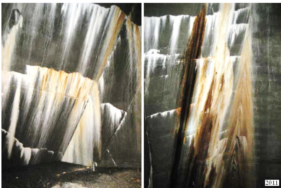
Figur 40. Sprickbildning i en tunn lamelldamm av betong med efterföljande läckage och urlakning i närheten av sprickan. Foto M Rosenqvist.
