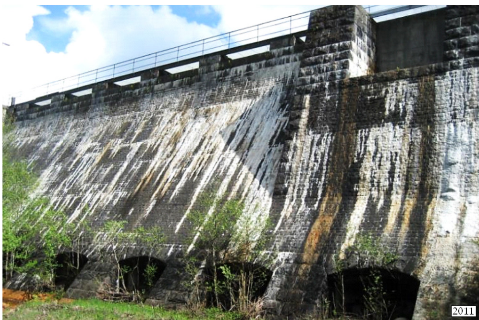
Figur 39. Urlakad kalk bildar vitfärgade utfällningar på dammens nedströmssida. Foto M Rosenqvist.
