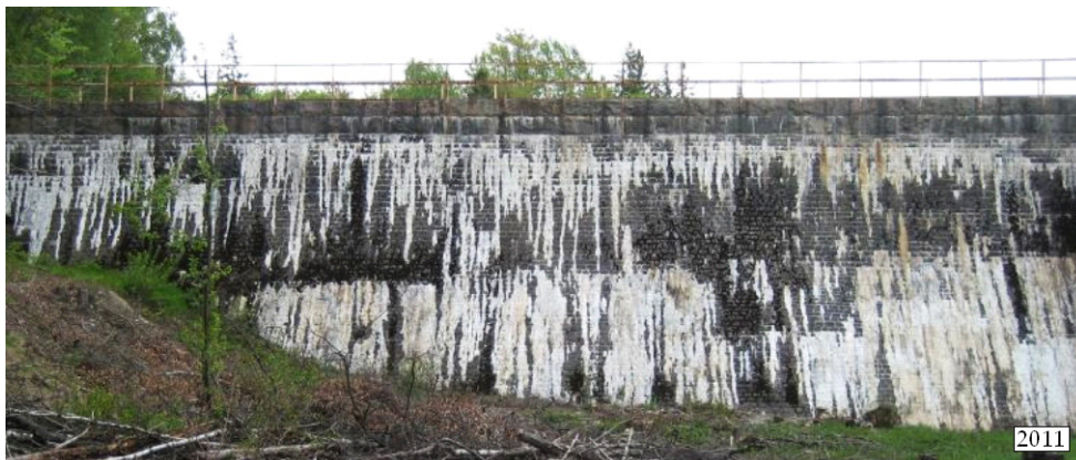
Figur 3. Massivdamm från tidigt 1900-tal där betongen har skadats genom urlakning. Den utlösta kalken har ansamlats på dammens nedströmssida där den syns som vitfärgade utfällningar. Foto M Rosenqvist.
