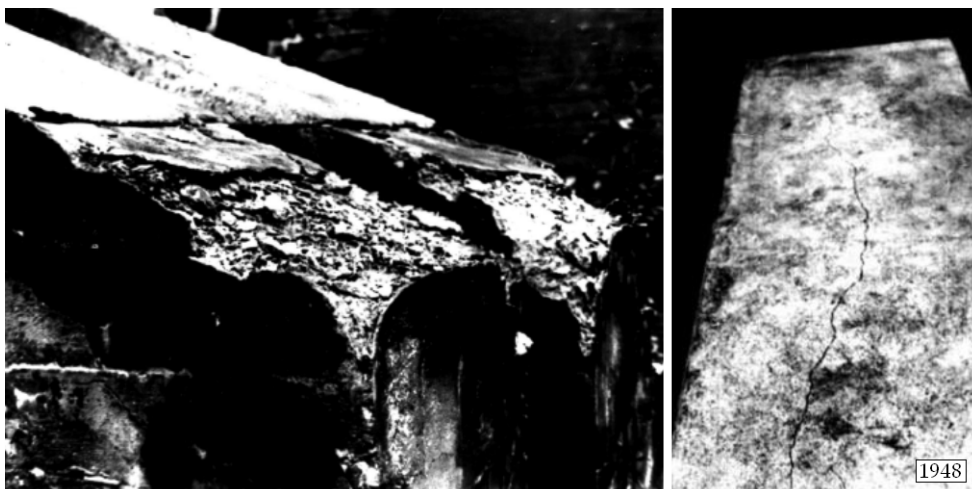
Figur 42. Fotografierna visar skadade betongkonstruktioner vid Norrfors kraftverk år 1948. De efterföljande undersökningarna visade att skadorna orsakats av svällande reaktioner. Fotografier från [87] (opublicerad).
