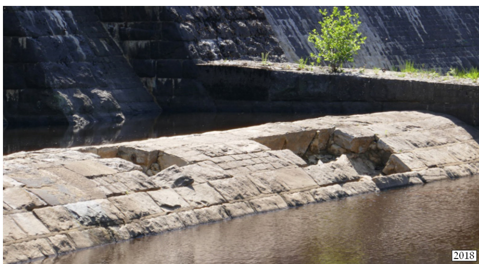
Figur 46. Erosionsskador på stembeklädd strålupplyftare av betong. Stora stenar har slitits loss och följt med de strömmande vattenmassorna nedströms. Foto M Rosenqvist.
