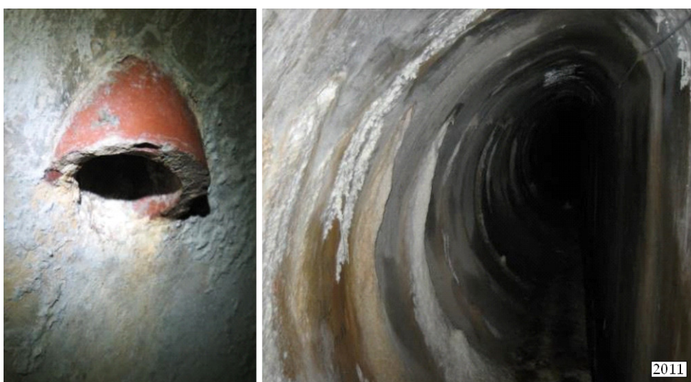
Figur 15. Dräneringsrör av oglaserat tegel i en massivdamm från tidigt 1900-tal (t.v.). Längs inspektionsgången sammanfaller placeringen av rören med de vertikala stråken med kalkutfällningar (t.h.). Foto M Rosenqvist.
