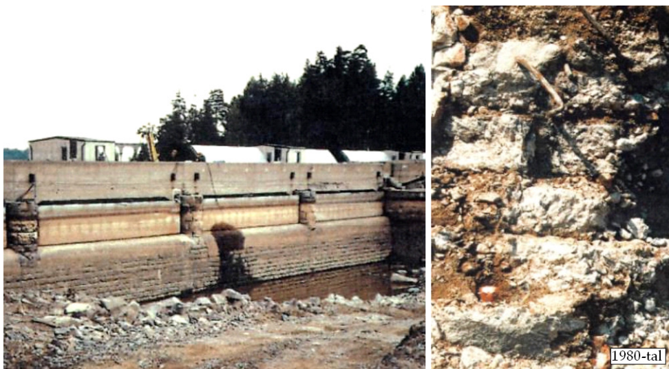
Figur 43. Nedbruten betong bakom avlägsnad stenbeklädnad i den gamla mellanfallsdammen vid Älvkarleby kraftverk. Fotografierna från [89] (opublicerad).
