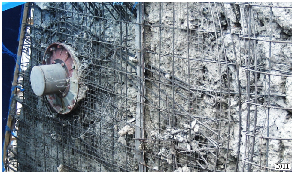
Figur 16. Armeringsjärn med ändkrokar vid förankringen av en segmentlucka i en utskovspelare. Armeringen har frilagts i samband med vattenbilning inför pågjutning av nytt ytskikt. Foto M Rosenqvist.
