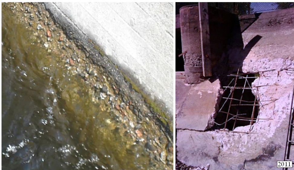
Figur 41. Två typer av frostskaas; (1) successiv nedbrytning av betongens ytskikt längs vattenlinjen samt (2) genomgående hål i en lamelldamm till följd av inre isinställväxt. Foto M Rosenqvist (t.v.) och Fortum (t.h.).
