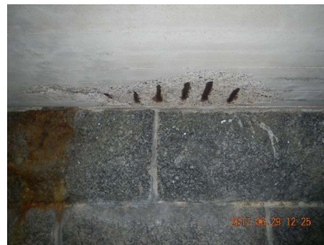
Platta (undersida) – spjälkning, armeringskorrosion
