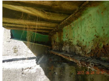
Balk – korrosion, areaförlust balkflänsar
