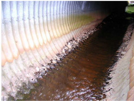
Rörbro – korrosion, areaförlust 100 %
