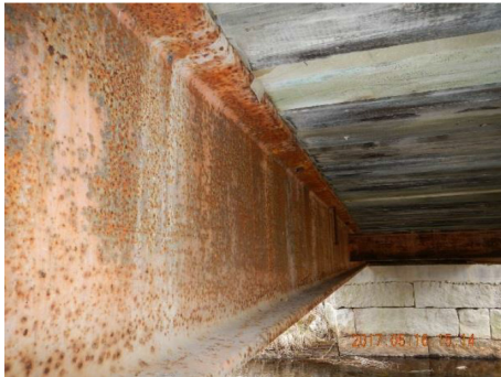
Balk ytbehandling – korrosion
