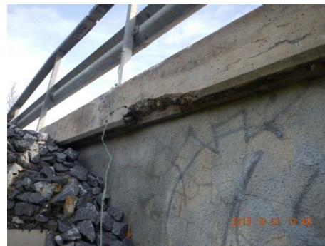
Kantbalk (utsida) – spjälkning, armeringskorrosion
