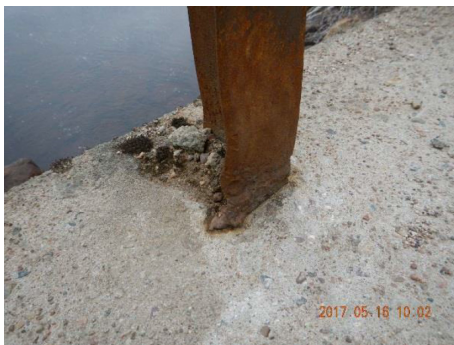
Räckesfot – korrosion, areaförlust
