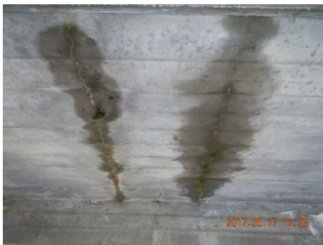
Platta (undersida) – läckage
