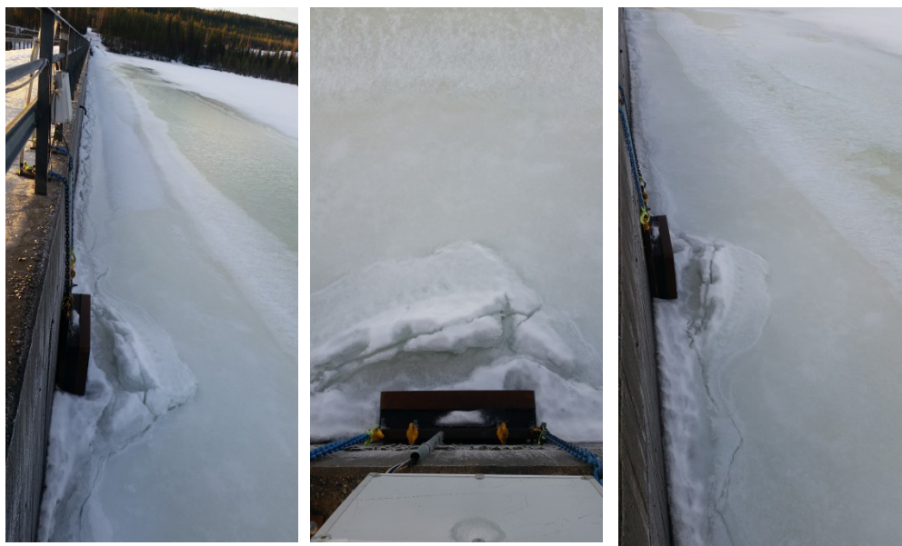
Figur 7-10 Spricka i istäcket som löper parallellt med dammlinjen. I fotot syns även att sprickan kröker runt lastpanelen. Foton tagna 2017-02-17
