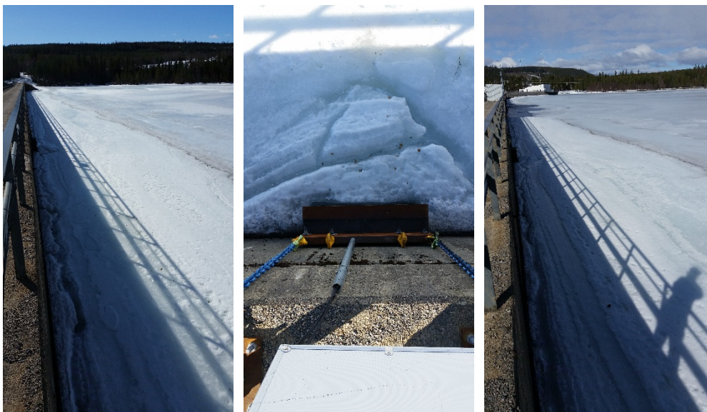
Figur 7-11 Spricka i istäcket som löper parallellt med dammlinjen. I fotot syns även att sprickan kröker runt lastpanelen Foton tagna 2017-03-29
