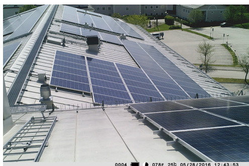
Figur 2. Anläggningarna Örnsköldsvik syd (närmast på högersida) och väst
