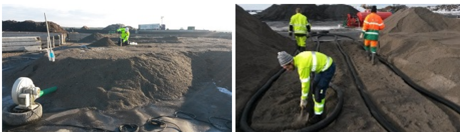
Figur 4 Karbonatisering slaggrus med installerade fläktar
