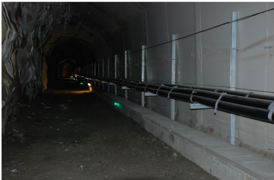
Figur 38: Kabelförband i tunnel med två parallella 3-fasgrupper i triangulär konfiguration. Kabelarea 1200 mm 2 . Vid arbete på det inre förbandet är det lätt att komma nära det yttre.
