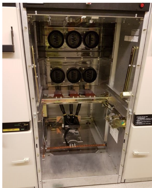
Figur 17. Kapslat ställverk typ Safesix för med brytarmodulen bortplockad för bättre åtkomst. Foto av Johan Brändström vid Sweco med tillstånd för publicering från Vattenfall.
