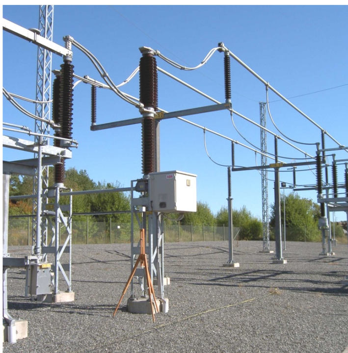
Figur 20. Mätning av E-fält invid ett manöverdon till en brytare i en 130 kV station av modern typ.
