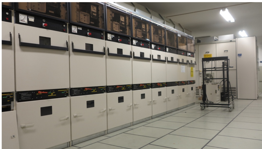
Figur 16. En rad med kapslade ställverk för 12 kV.
