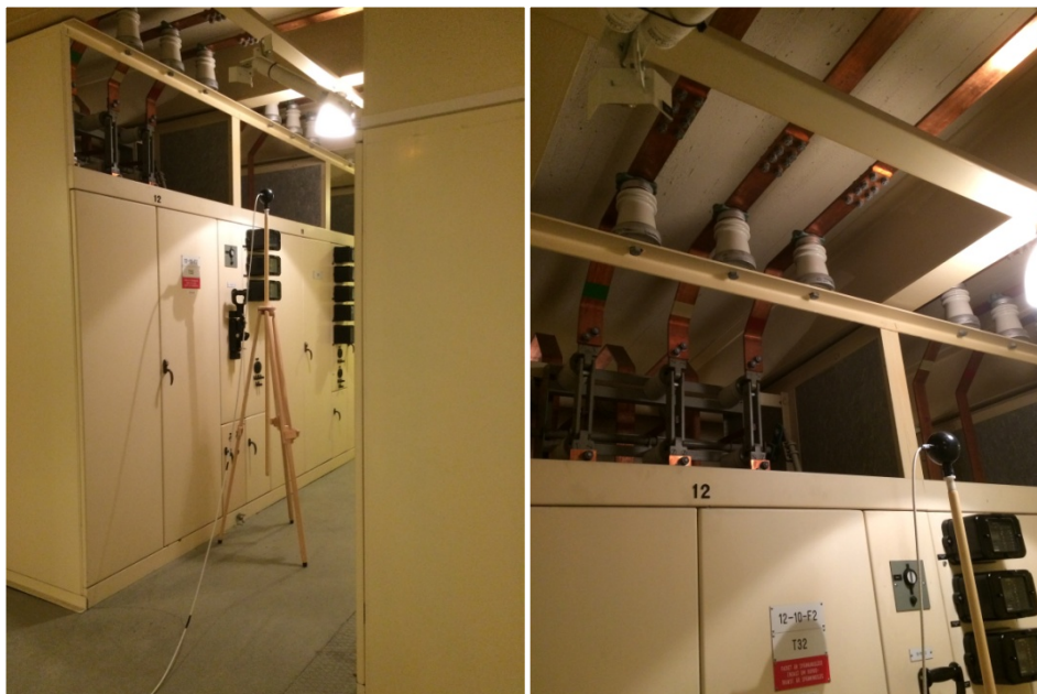
Figur 19. Mätning av E-fält framför ställverksfack av äldre typ med öppna skenstråk. Foto Anders Bad, Sweco.
