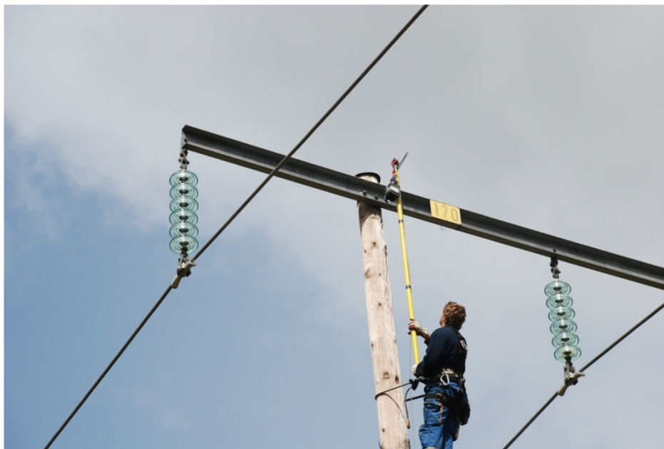
Figur 2. Mätning av magnetfält längs det ena benet i en stolpe för 130 kV.
