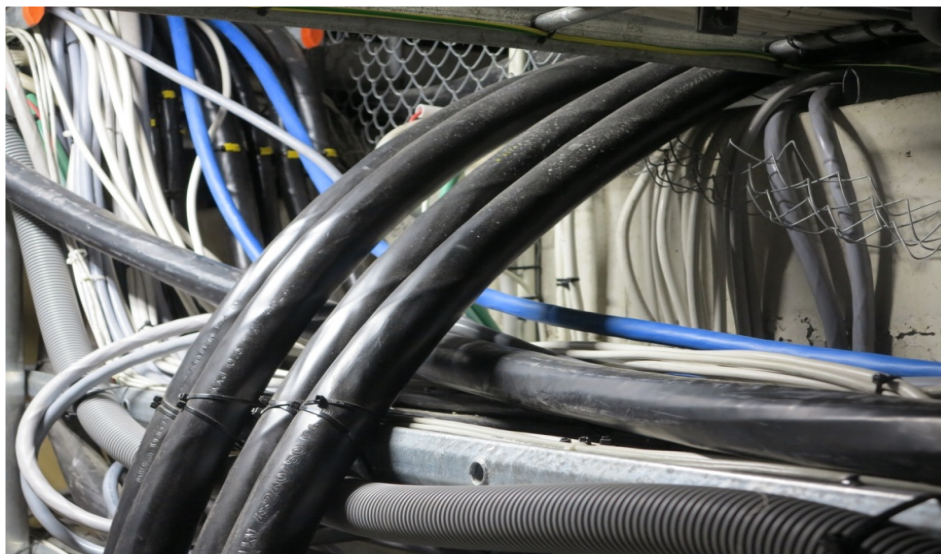
Figur 37. Högspänningskabel tillsammans med signal- och annan kraftkabel. Vid arbete med en kabel är det lätt att komma nära andra kablar.
