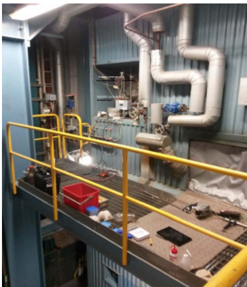
Figur 16 Provtagning av flygaska vid utlopp, panna. Elfiltret är placerat utomhus, på andra sidan väggen, till vänster i bild. Foto: Ilema
