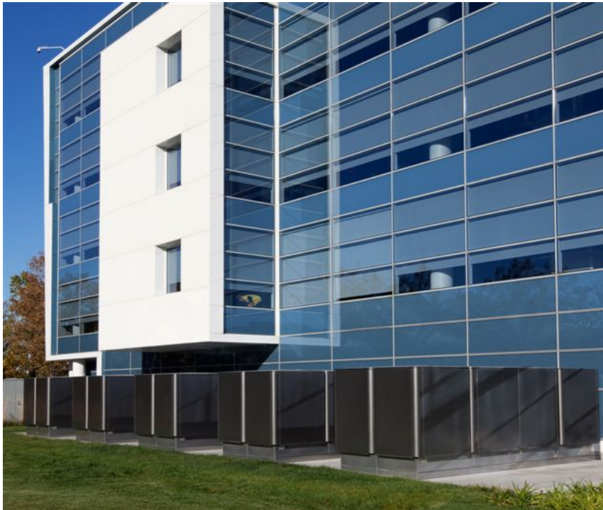
500kW SOFC installerat på Ebay Campus San Jose, CA
