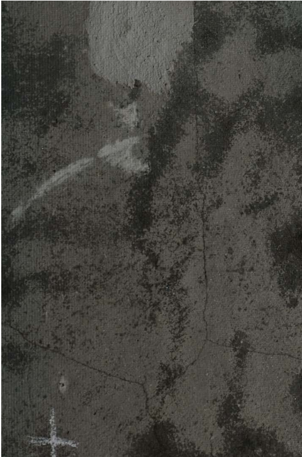
Figur B 16 De skarpa bilderna kameran tar kan användas för att detaljstudera den undersökta ytan. Ovan visas en spricka i bildens nedre vänstra hörn. Det bedöms att denna typ av fotografering, med utnyttjande av de ljuseffekter en projektor kan ge, kan vara till stor nytta. Bl a kan ytans topografi studeras genom att man med snett infall projicerar linjer på ytan.
