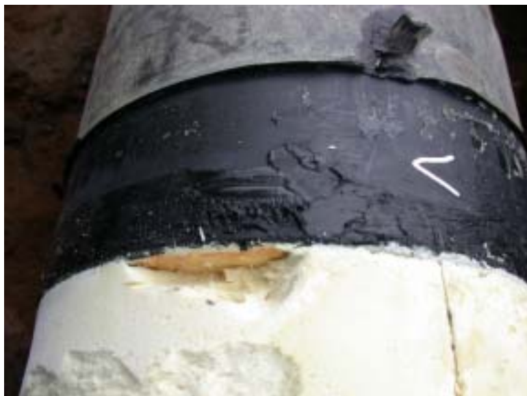
Figur 4.17 Bristfällig vidhäftning mellan skarvskum och rörände på väster ände av framledningsskarven på Marklandsgatan. Poor adhesion between joint foam and pipe end on west end of flow pipe joint at Marklandsgatan.
