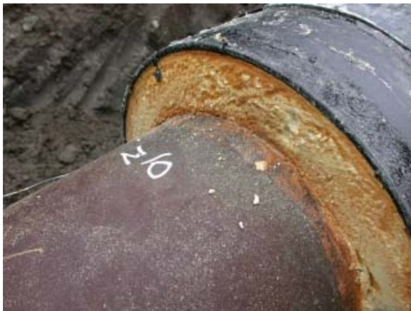
Figur 4.9 Rörände i framledningskarven. Pipe end in the flow pipe joint.
