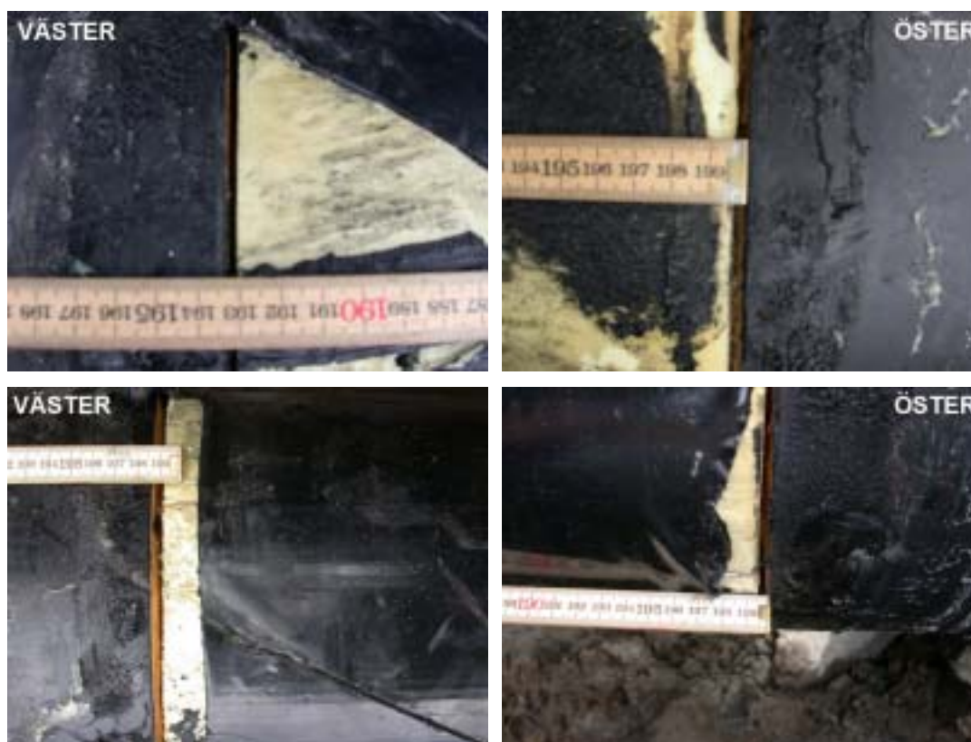
Figur 4.8 Luftspalter mellan skarvisolering och rörändar på framledning (överst) respektive returledning vid Gustaf Melins gata. Air-gaps between joint insulation and pipe ends on flow pipe (top) and return pipe respectively at Gustaf Melins gata.
