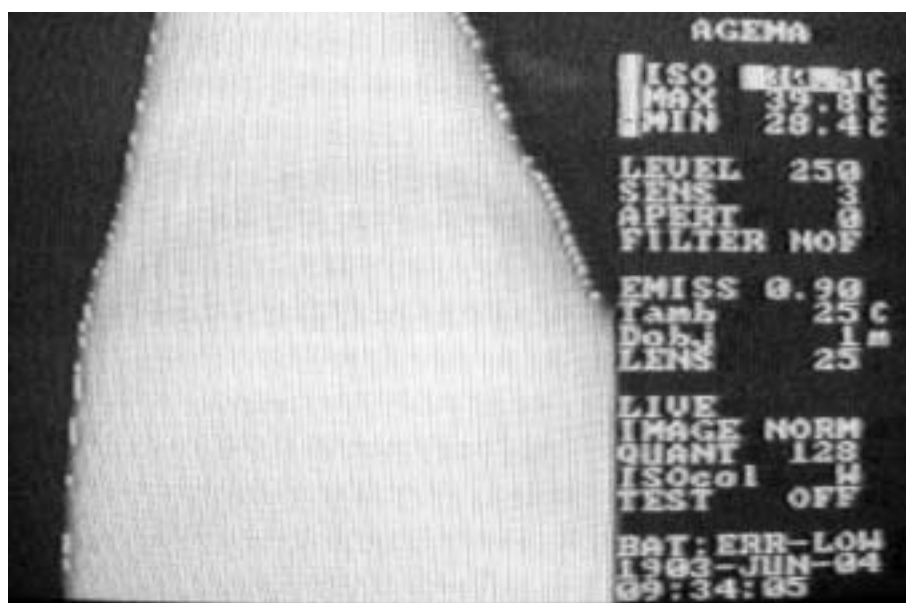
Figur 4.15 Termogram över skarven på framledningen vid Marklandsgatan. Thermogram of the flow pipe joint on Marklandsgatan.
