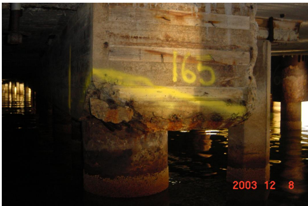
Figur 31 Korrosionsskador på armering till betongpåle över vattenytan (foto Göteborgs hamn).
