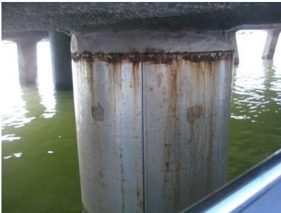
Figur 34 Betongpålar med isskydd av syrafast rostfritt stål i Göteborgs Hamn. Isskydden är kraftigt korroderade på plåtkanten ovasida.
