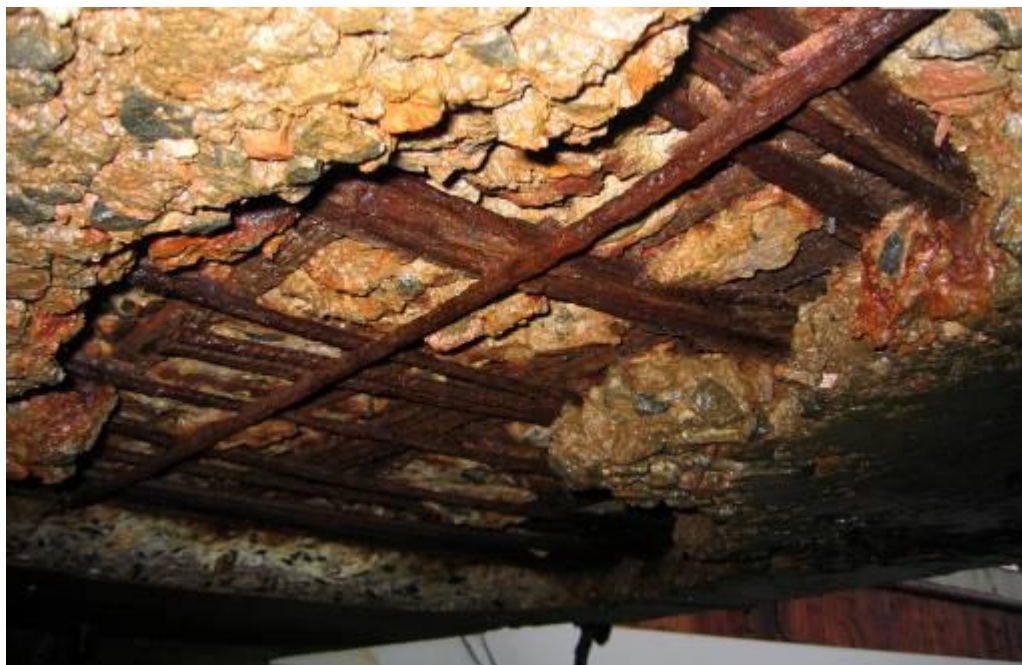
Figur 32 Kraftiga korrosionsskador på armering till undersida kajdäck. (foto Göteborgs hamn).
