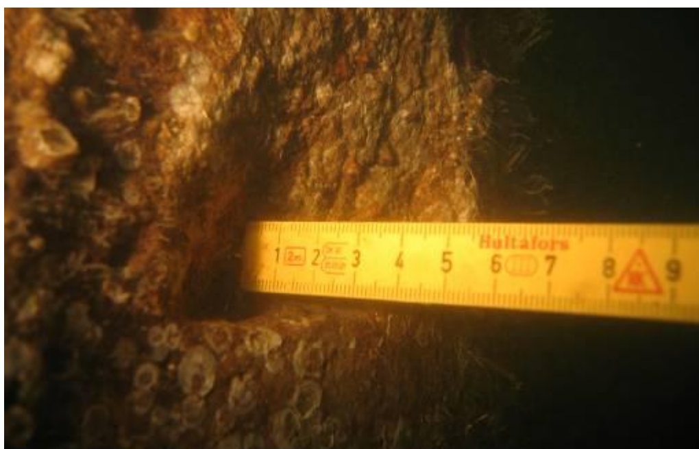
Figur 33 Rostutfällning på betongyta till armerad betongpåle under vattenytan (foto Göteborgs hamn)
