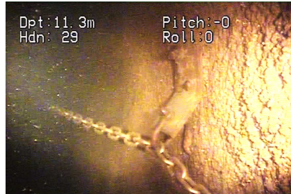
Figur 5.14. Bild från utsläppstunneln vid F3 maj 2007, 184 m nedströms. Påväxt saknas på kättingen eller fästet i betongväggen.
