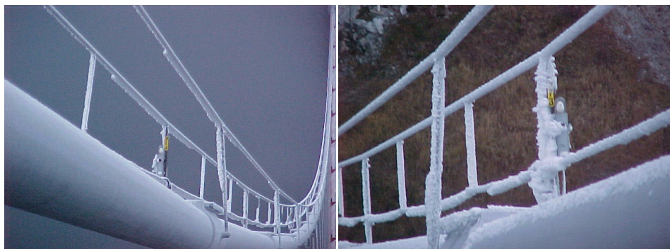
Figur 25. Nedisning på Högakustenbron 2003-11-14. Foto från Tommy Sundquist, Vägverket.
