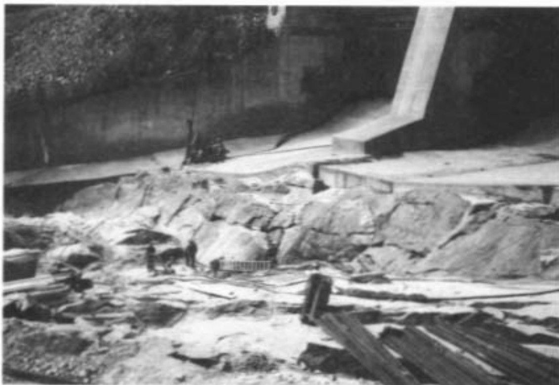
Figur 4.4.a. Reparation och förstärkning nedströms utskov på grund av berg som ryckts loss.
