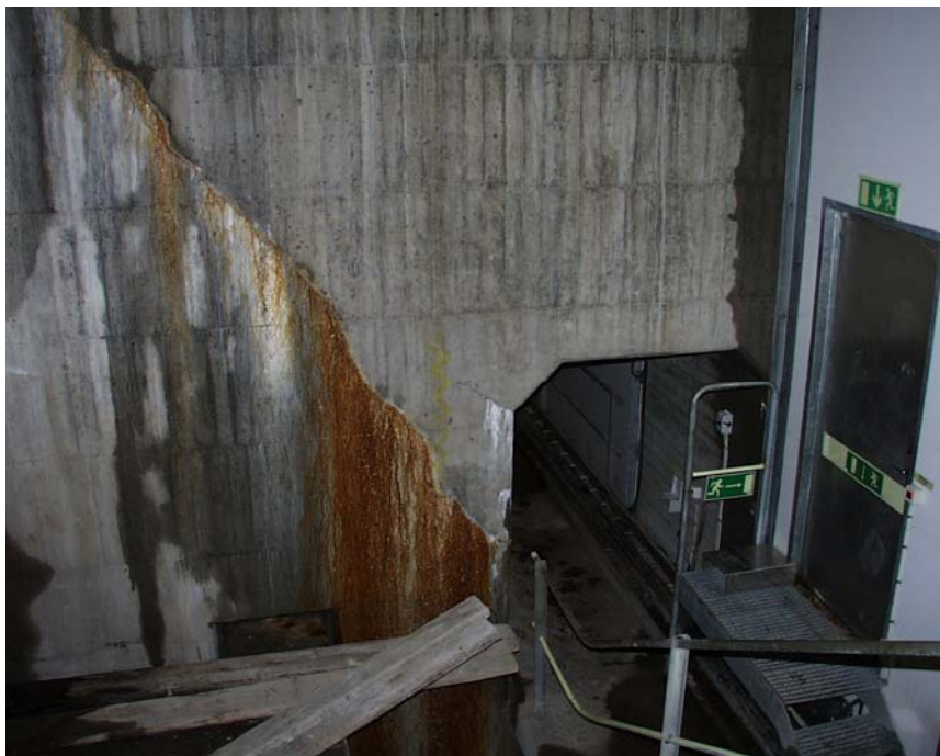
Figur 9.4 Diagonal spricka på ett stöd.
