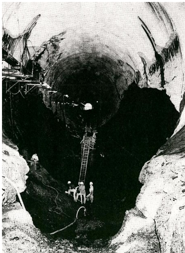
Figur 3.1 Bild som visar den omfattande kavitation- och erosionskadan i den 300 m långa avbördningstunneln.
