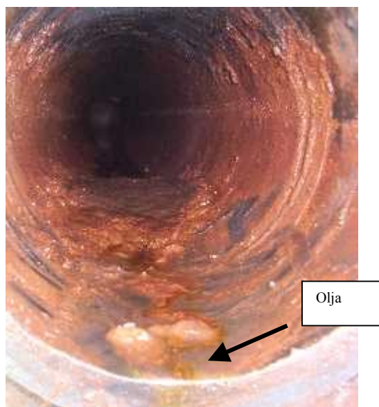
Figur 11. Slam och olja i fördelningslådan i economizerpannan
