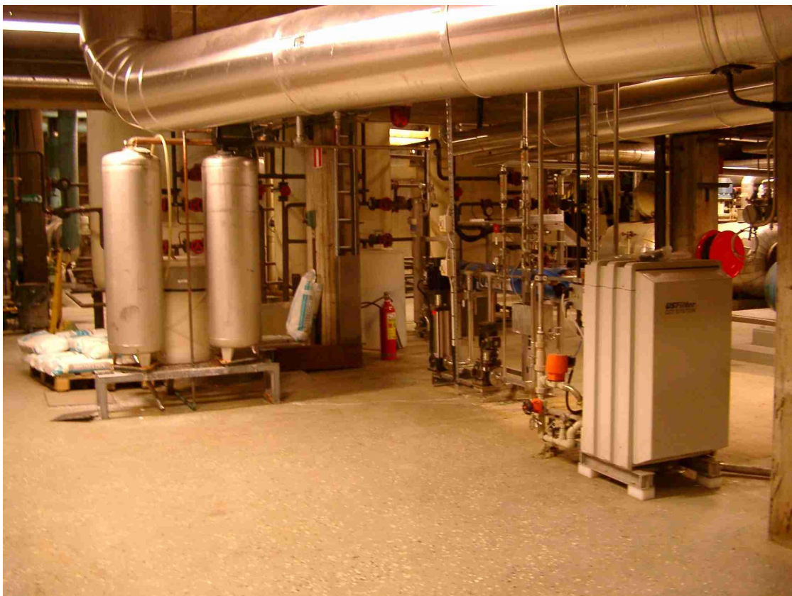
Avsaltningsanläggningen, från vänster avhårdning, RO och CDI
