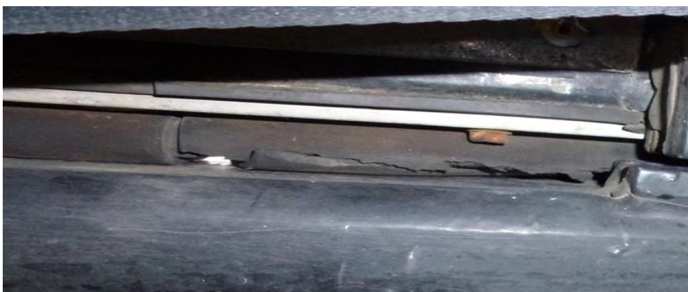
Figur 4-9 Exempel på krackelerad fogmassa i kärnkraftverk, troligtvis p g a värme.
