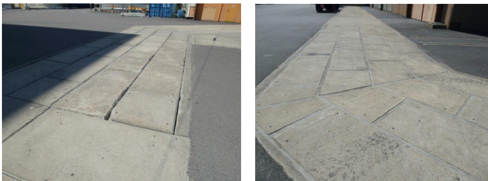
Figur 2-1 Till vänster visas foto från en kulvert, där fogmassan försvunnit p g a slitage. Till höger visas fogar med nyligen applicerad fogmassa.
