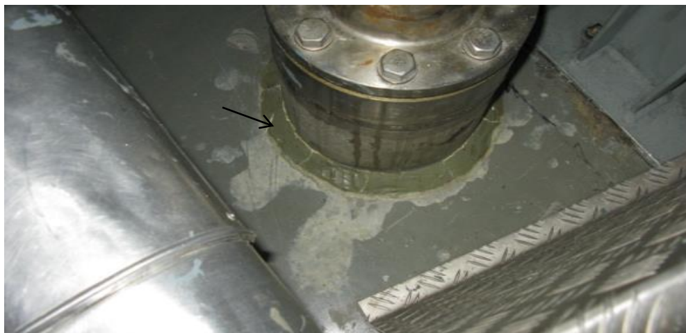
Figur 1-1 Exempel på fog/tätning (krackelerad) i reaktorinneslutning hos OKG (O3).
