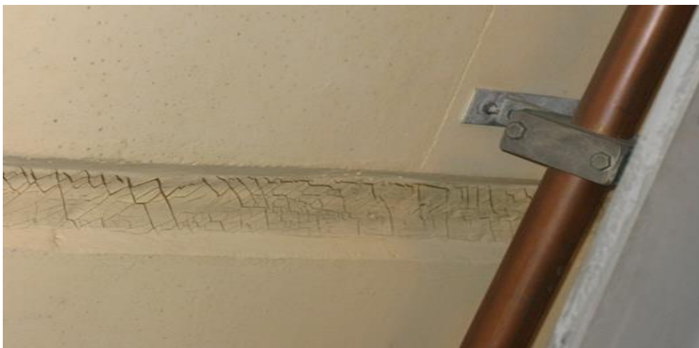
Figur 4-8 Exempel på krackelerad, målad fogmassa i kärnkraftverk.
