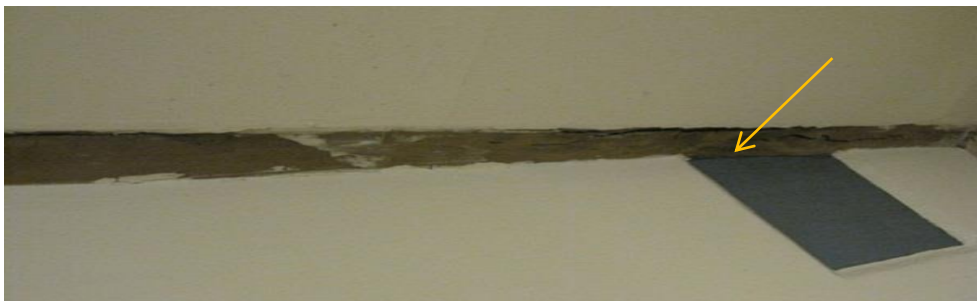
Figur 4-3 Polyuretanfog med sprickor och dålig vidhäftning (se pilen).
