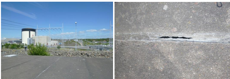
Figur 4-1 Exempel på fogmassa i betong som åldrats p g a solljus (UV-stålning).
