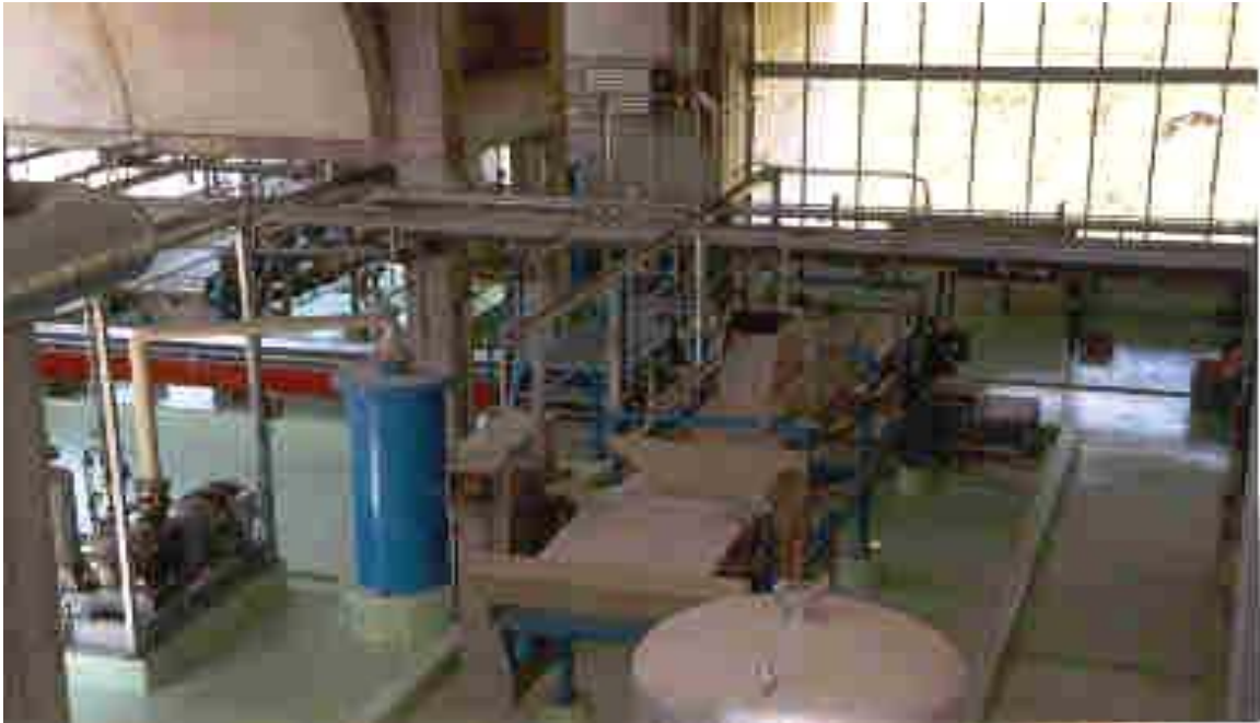
Figur 14. Foto över utrustningen för att tvätta flygaskor (RGR) vid avfallsförbränningsanläggningen i Sion. Källa: Techfinas Internet-site [114].
