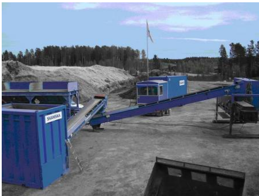
Figur A.1 Blandningsanläggningen med matarfickor för avloppsslam, flygaska, transportband och blandare. I bakgrunden ligger kontrollhytten.
