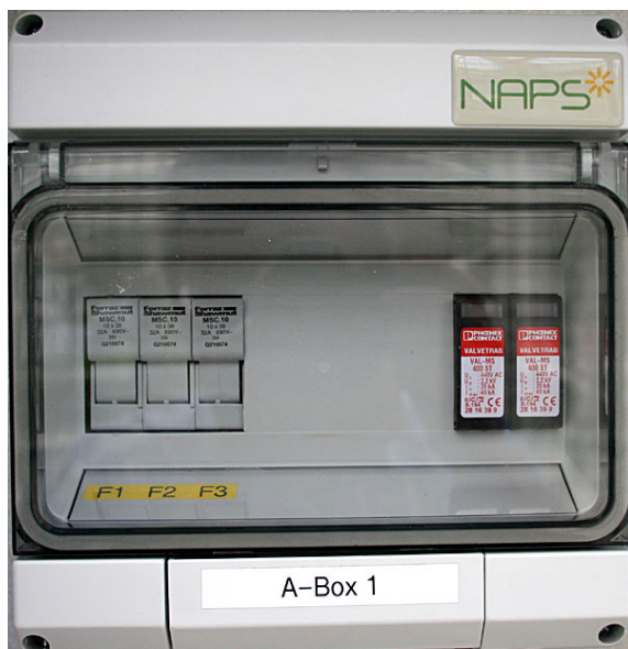
Figur 3.2 Kopplingslåda för solcellsmoduler. En kopplingslåda används per fas. Säkringshållarna ses till vänster (två av tre möjliga används i denna anläggning) och överspänningsskydd till höger.
