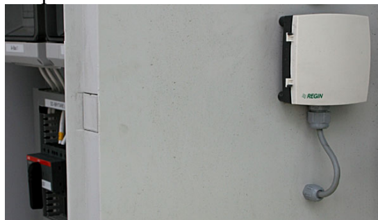
Figur 3.13 Temperaturgivare på utsidan av ett av utomhusskåpen.
