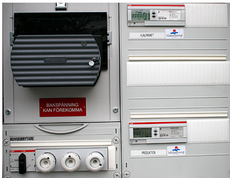
Figur 3.10 Detalj av kabelmätarskåp. Överst till vänster timavläsare. Nedanför den lastbrytare och porslinsbrytare. Till höger elmätare för förbrukning och produktion.
