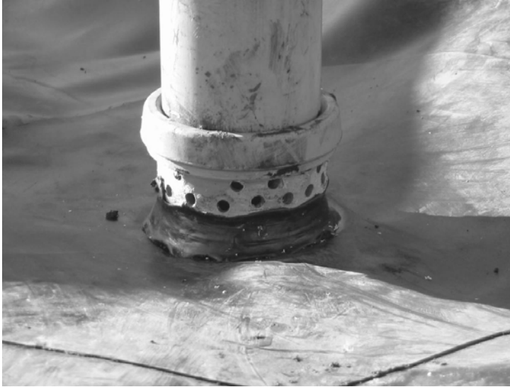
Figur A-4. Exempel på utlopp för lysimeter. Stos svetsad mot geomembranet och med utloppsledningen ansluten.
