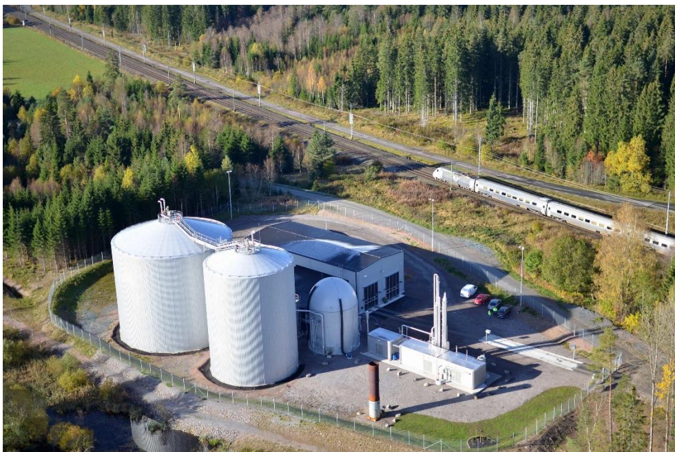
Figur 1. Göteborg Energis biogasanläggning i Sävsjö. Källa: Purac Puregas AB.
