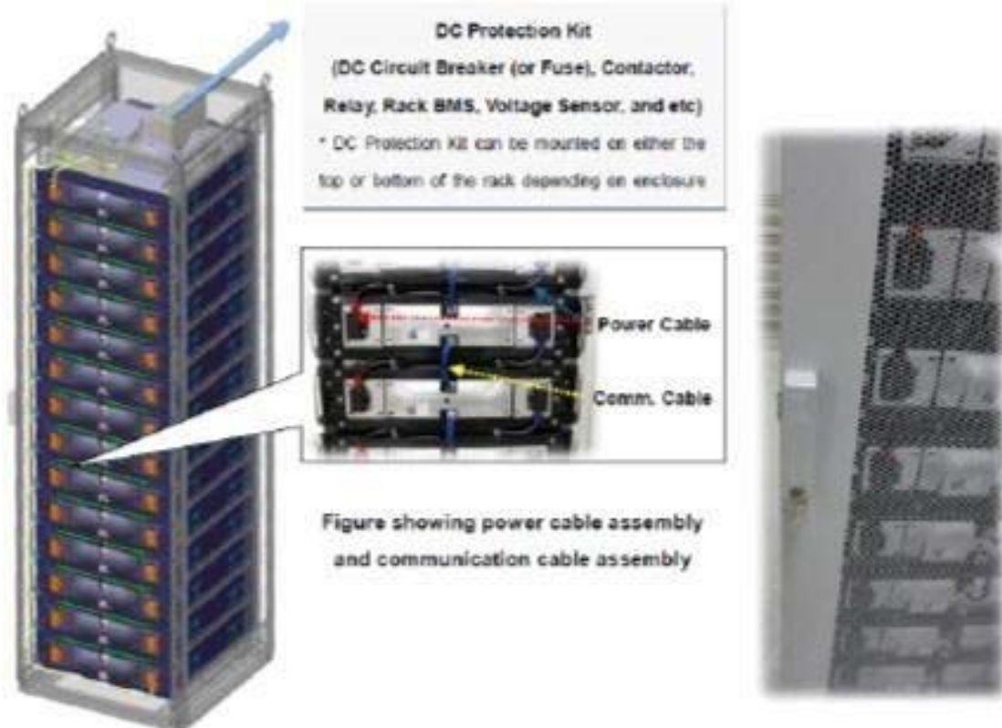
Figur 5: Rack R800 från LG Chem med 14 moduler.
