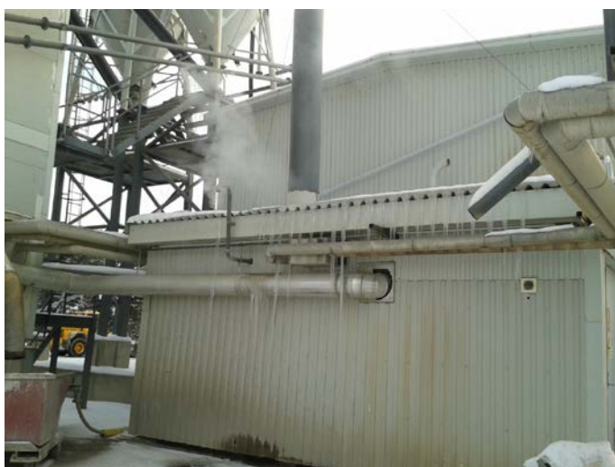
Figur 22. Utsidan av pannrummet till en betongstation med oljepanna. När ångbehovet är lågt ångas kondensatet bort.
