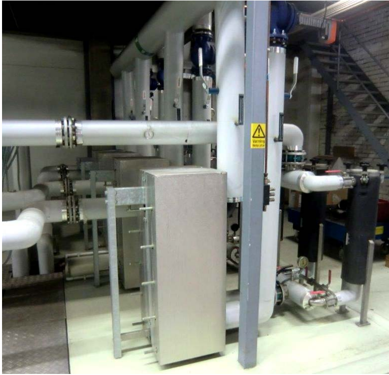
Figur 16. Värmeväxlare för värmning av avfettningssteg. Längst till höger ses svarta parallellkopplade patronfilter. Parallellkopplingen möjliggör service under drift. Källa: Toyota Material Handling Europe.
