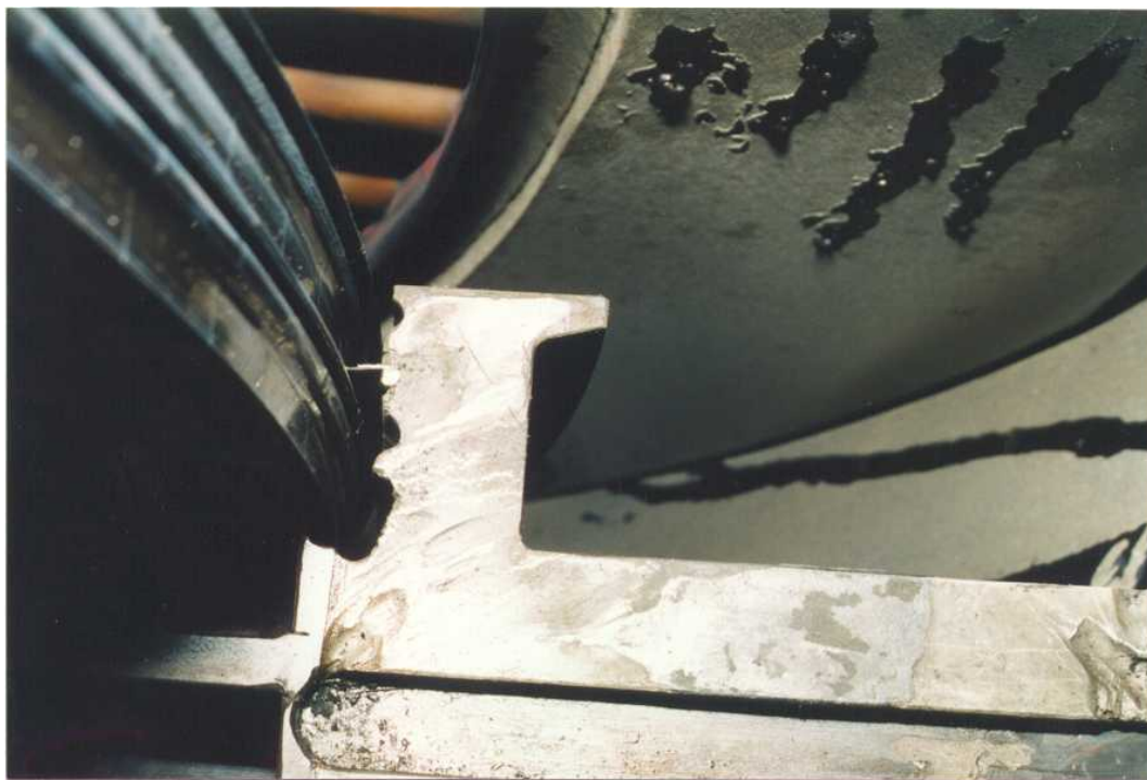
Figur 98. En tätkant har lossnat p.g.a. det djupa angreppet
