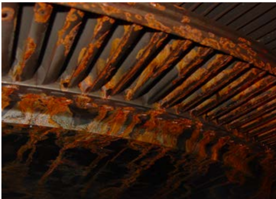
Figur 105. Stilleståndskorrosion i en ångturbin, före rengöring.
