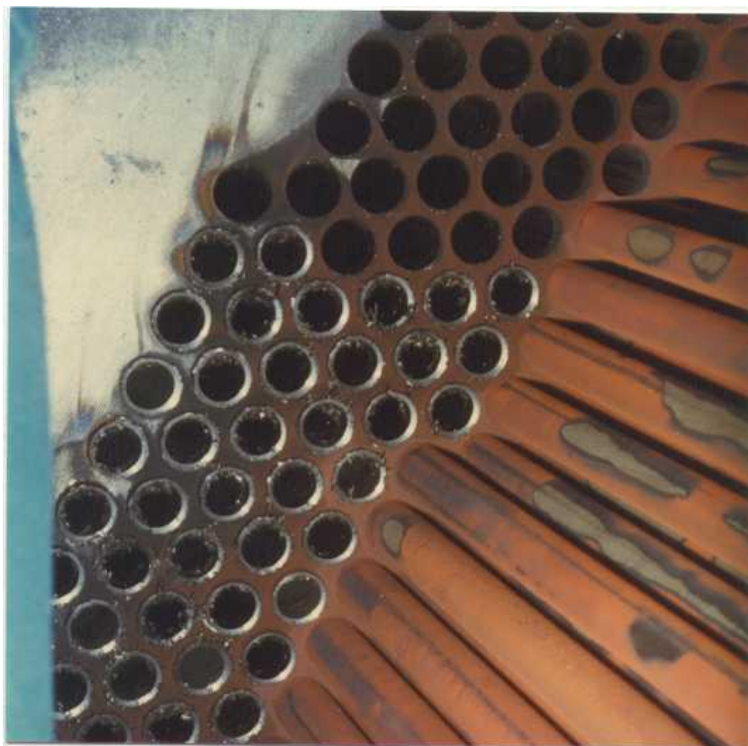
Figur 100. Erosionskorrosionsangrepp på ångsidan av tuberna i en värmekondensor
