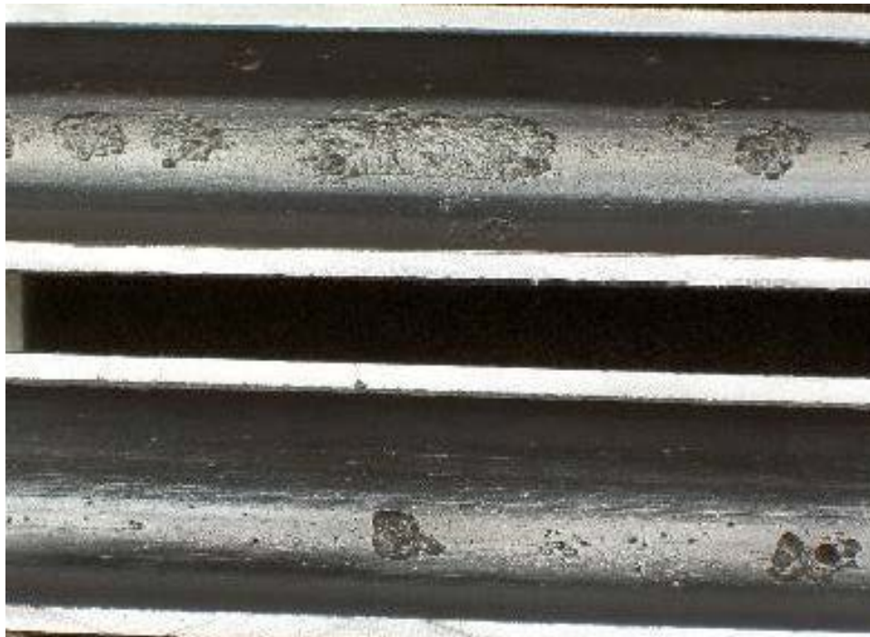
Figur 57. Exempel på angrepp i metallen från avlagringskorrosion.
