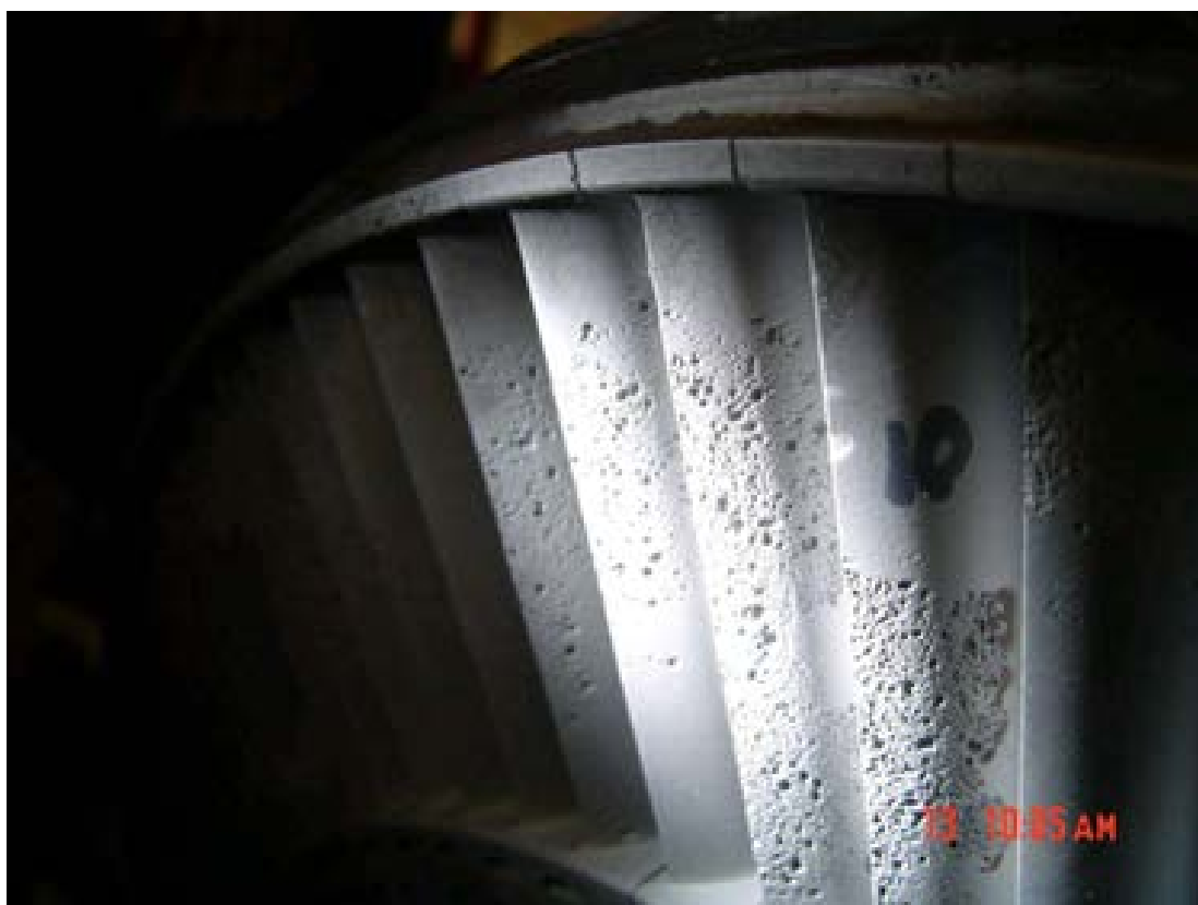
Figur 106. Stilleståndskorrosion av typ gropfrätning i skovlar av 12 % Cr kromstål, efter rengöring.
