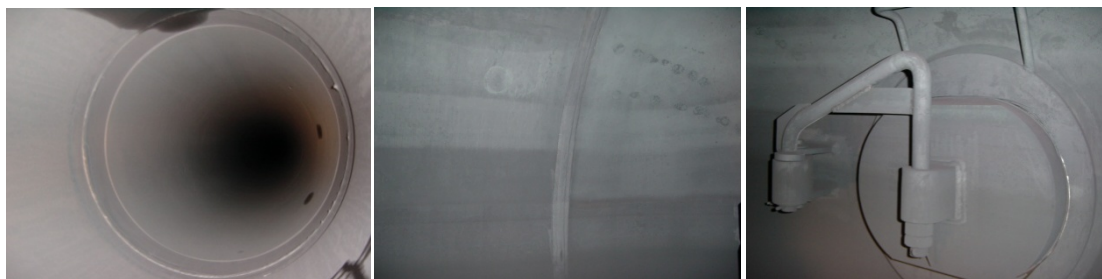
Figur 203. Foton från inspektion av en panna med bra magnetitskikt utan beläggningar och korrosionsangrepp.
