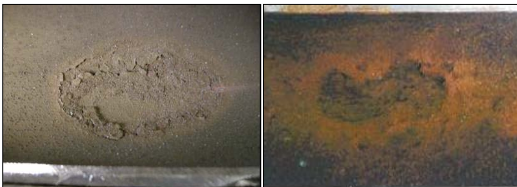
Figur 70. Tubytan utanpå fläckar där kopparfolier bildats.
