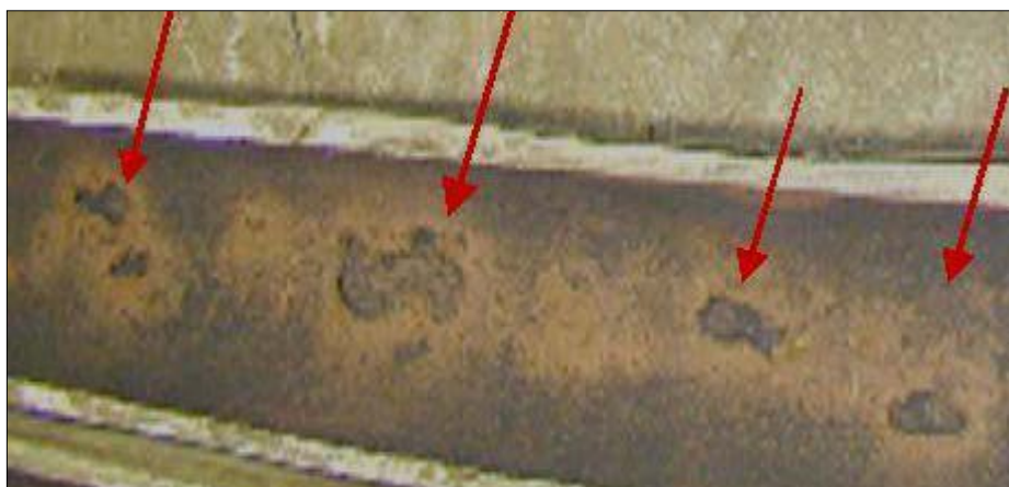
Figur 73. Rengjorda gropar från skador under kopparbeläggningar.
