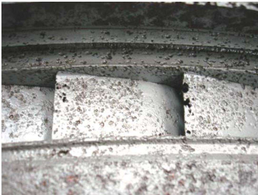
Figur 107. Stilleståndskorrosion av typ gropfrätning i ledskenorna av 12 % Cr-stål, efter rengöring
