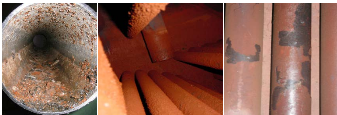
Figur 202. Foton från inspektion av pannor med omfattande beläggningar och korrosion.
