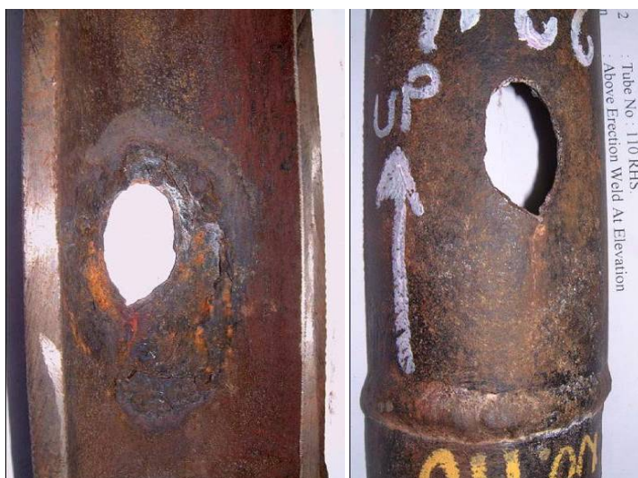
Figur 75. Insidan och utsidan på tubskada orsakad av att kopparfolie bildats på insidan.
