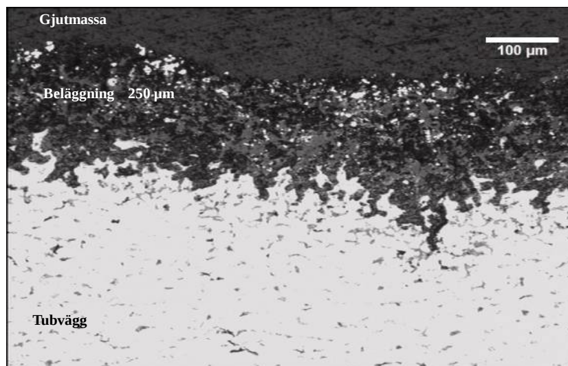
Figur 56. Kraftiga angrepp i tubväggen från avlagringskorrosion
