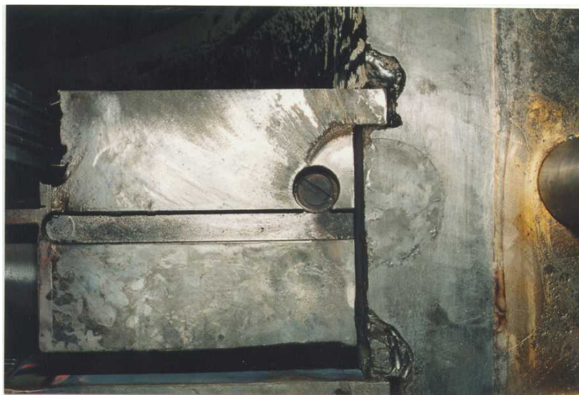
Figur 97. Mellanvägg med djupa erosionskorrosionsangrepp
