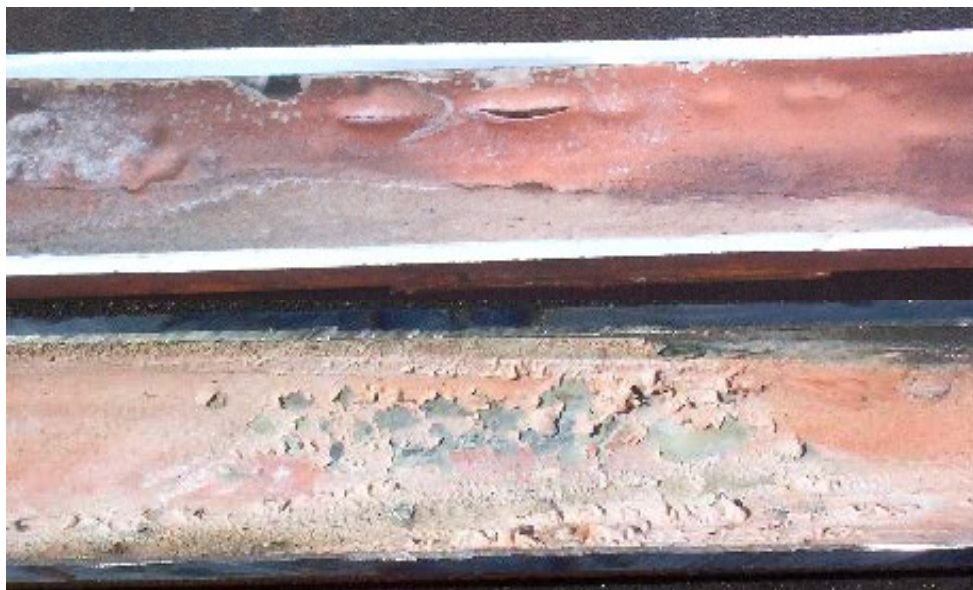
Figur 47. Exempel på beläggningar i första tubraden i första överhettaren
