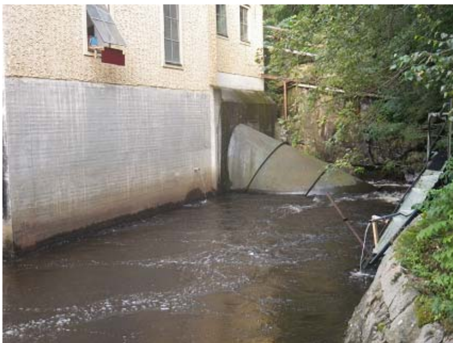
Figur 4. Ålyngeluppsamlaren vid position 4 (Fig. 1, Pos. 4). Notera strålkastarnas placering överst i bild vid det öppna fönstret.
