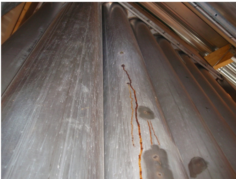
Fig. 13 Utsida av rökrör penetrerade av pitting. Material EN 1.4436 (SS 2343)
