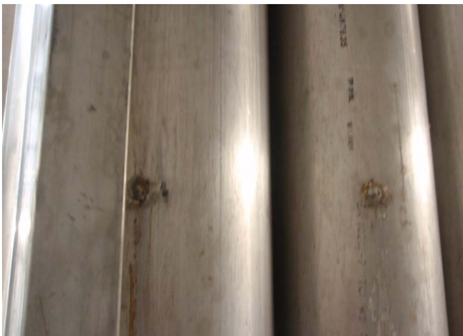
Fig. 14 Utsida av rökrör penetrerade av pitting. Material EN 1.4404 (SS 2348)
