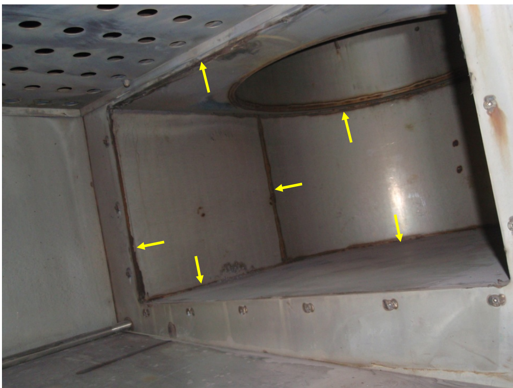
Fig. 5 Korrosionsangrepp i anslutning till svets-skarvar. Rök-gasberörd del efter trycklös kondensor med indirekt värmeöverföring. Material EN 1.4436 (SS 2343).
