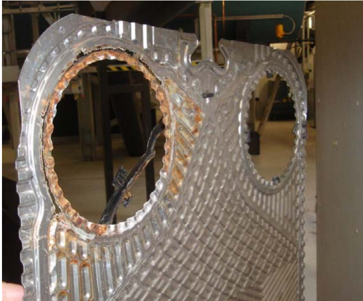
Fig. 15 Spaltkorrosion i värmeväxlarpåt. Material EN 1.4436 (SS 2343)
