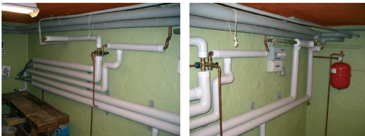
Figur 4. Färdig installation i villa. Foto: FVB Sverige ab
