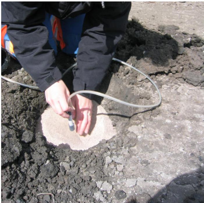
Figur 2-14 Installation av gasprob med sandfilter i tätskiktet.
