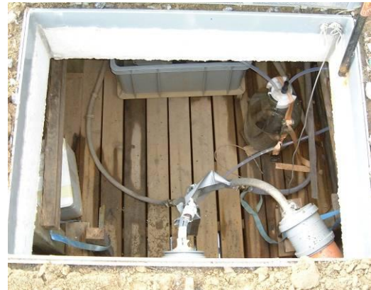
Provtagningsbrunn 5 vid referenssträckan.
