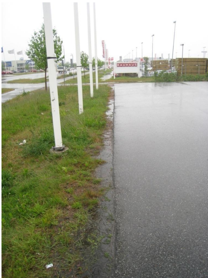
Figur 35. Vattensamlingar utmed asfaltkanten.
