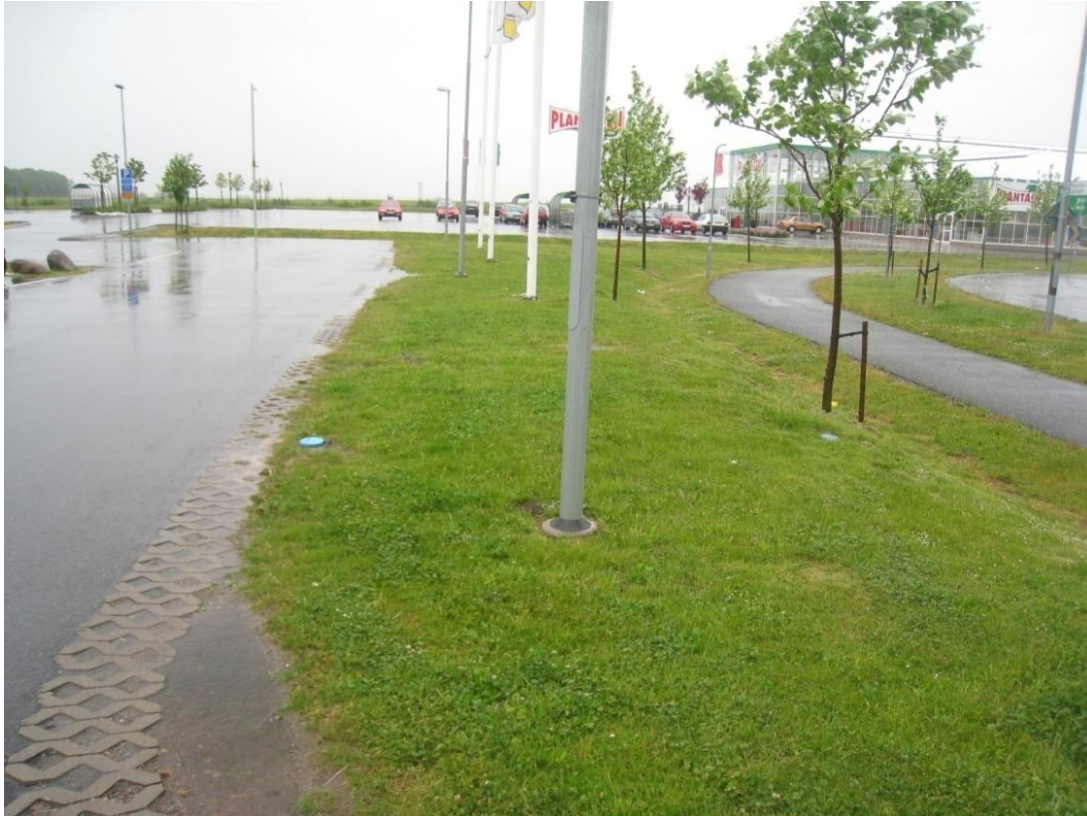
Figur 56. Vattensamlingar utmed asfaltkanten.
