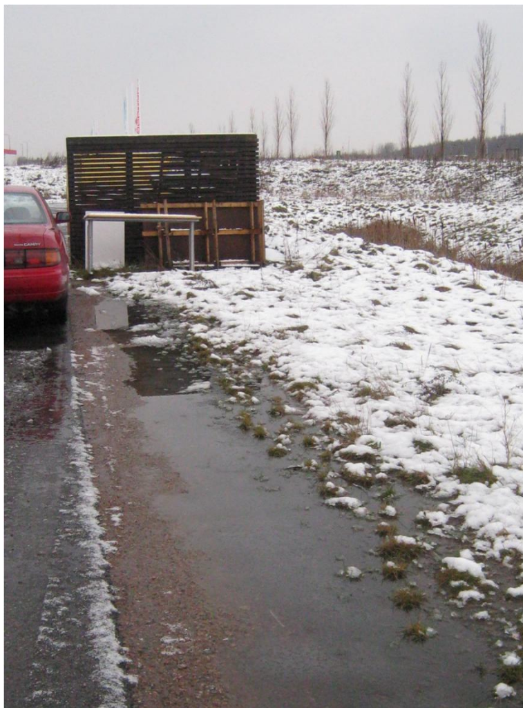
Figur 50. Vattensamlingar utmed asfaltkanten.
