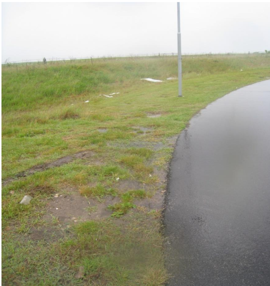
Figur 61 Vattensamlingar utmed asfaltkanten.
